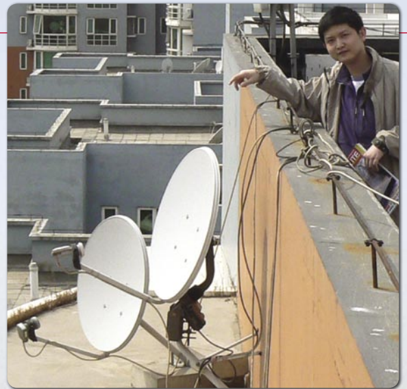
■ An einer Seitenbrüstung sind noch weitere Spiegel montiert: ein 75cm Spiegel ist auf 134E ausgerichtet und der 60cm Spiegel ist mit einem MOTECK Motor drehbar montiert.
