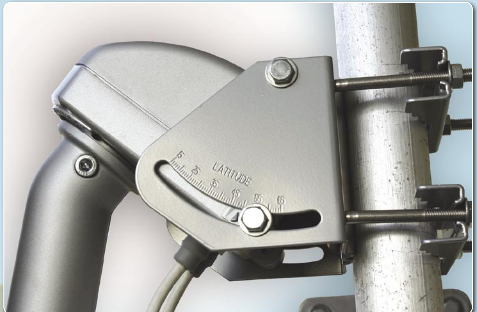
Drehmotor am Mast angebracht
