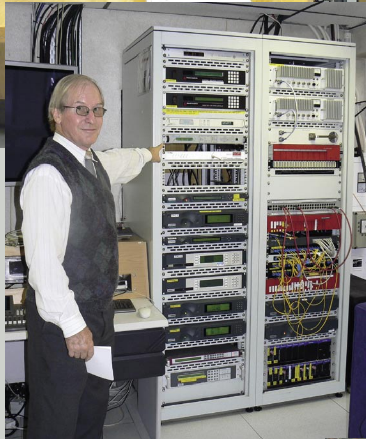
▲ Clive Grove ist Project Engineer bei Telemidia, und zeigt uns hier den Schrank mit den Encodern. Clive stammt aus England, und installierte in vielen Ländern Afrikas Satellitenspiegel. Er ist übrigens auch TELE-satellite Autor!
