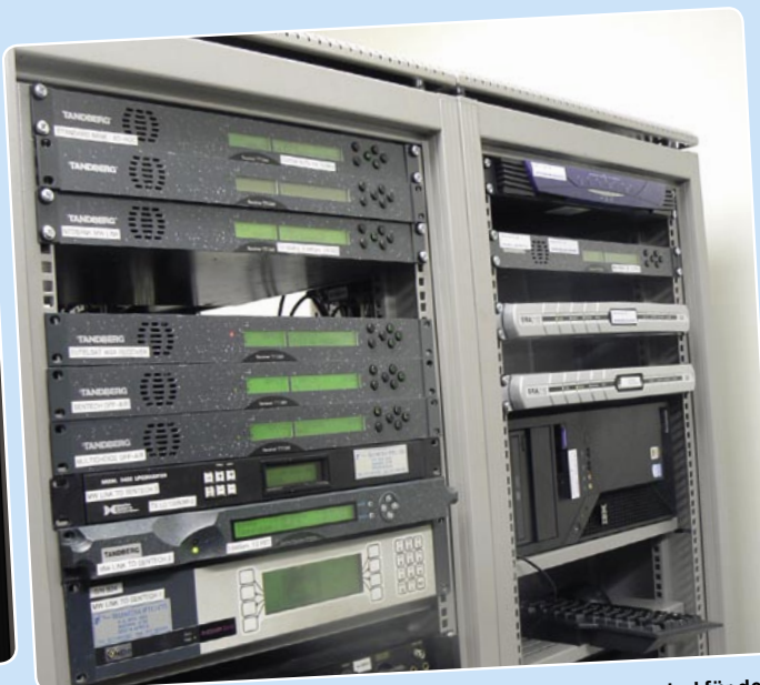
Hier werden die Signale aufbereitet. Die Tandberg Einschübe sind für den Satellitenbetrieb, die Einschübe für die terrestrischen Mikrowellenverbindungen zu SENTECH, dem südafrikanische Dienstleister für die Verbreitung der Signale.
