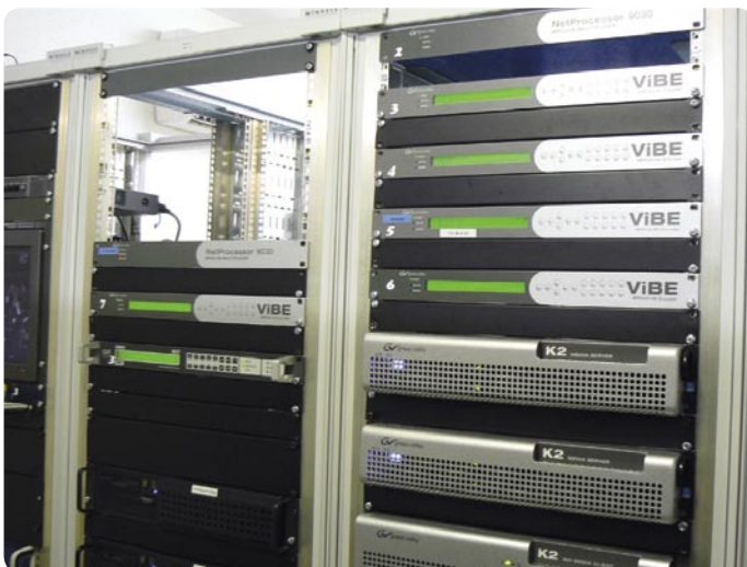
▲ Hier werden die Programme sendefähig in MPEG-4 aufbereitet und zum Uplink geleitet.
