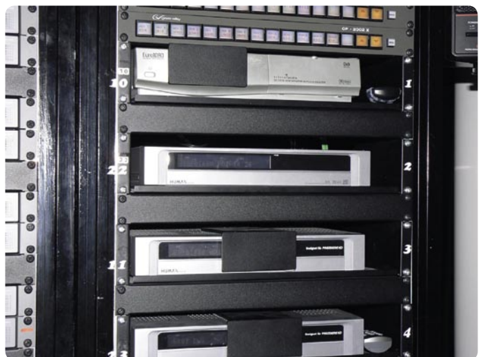
▲ Das Sendesignal wird mit Hilfe von handelsüblichen HDTV-Receiver, z.B. von HUMAX, kontrolliert
