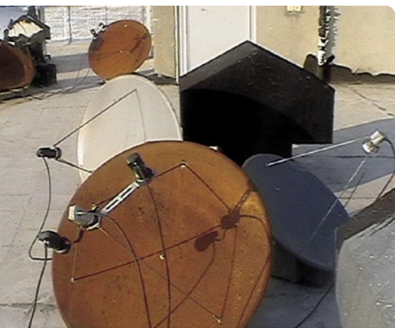
Ein Flachdach hat auch seine Vorteile: genug Platz für Antennen. Die Antenne im Vordergrund hat sogar Multifeed-Empfang!
